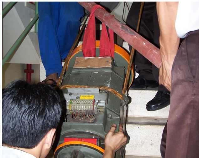
Gambar 4 Motor dikeluarkan dari ruang mesin untuk rewinding
